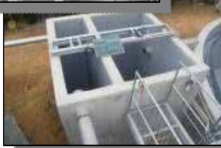
施工例 食品加工工場排水処理設備
